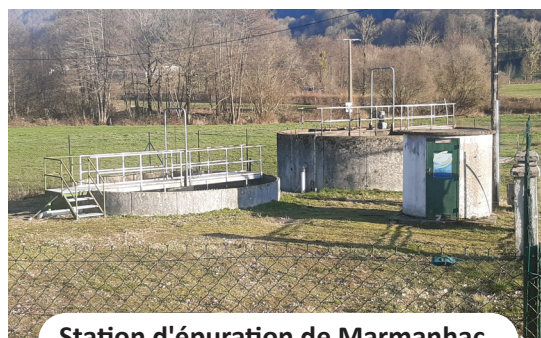
Station d'épuration de Marmanhac
